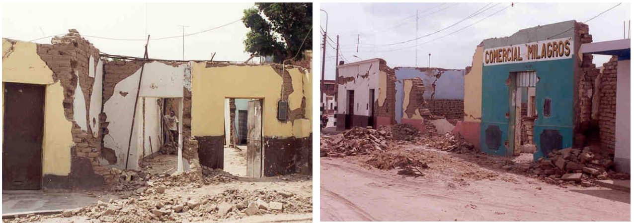
Fig. 2.- Colapso de Viviendas Antiguas de adobe ubicadas en Jr. Lima, Nasca.
