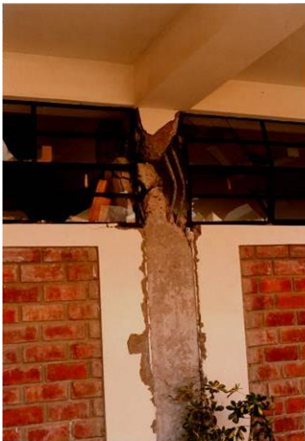
Fig. 7.- Colegio Fermín del Castillo, Vista Alegre, Nasca. Columna corta sin estribos.
