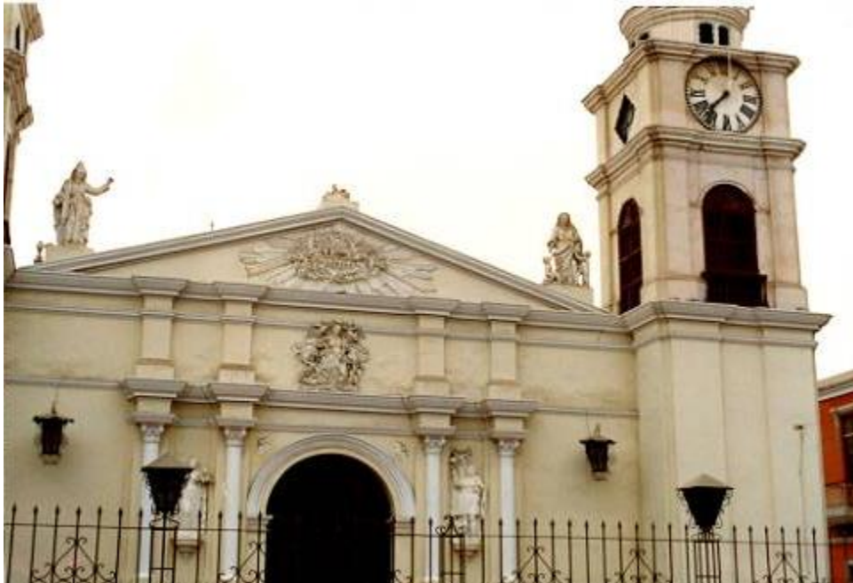
Fig. 9.- Catedral de Ica. Caída de estatua y fisura de torre.
