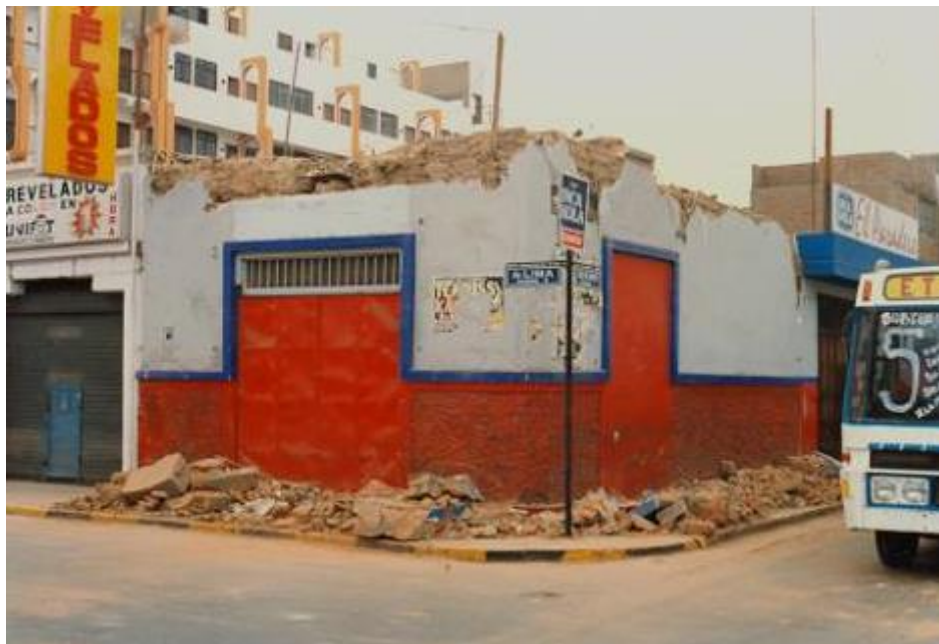
Fig. 4.- Desplome de parapeto en Ica.
