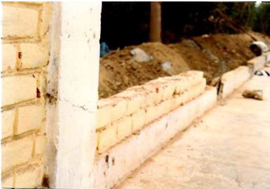
Fig. 10.- Cerco del estadio Picasso Perata, Ica. Refuerzo inadecuado.
