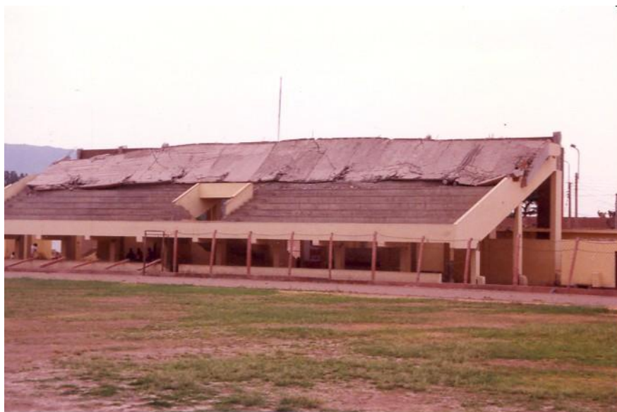
Fig. 12.- Estadio Municipal de Nasca. Colapso del techo de la tribuna.
