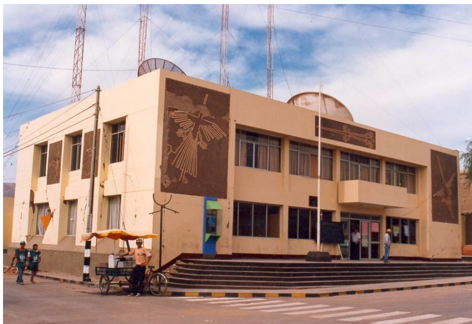
Fig. 11.- Municipalidad de Nasca. Fallas en la tabiquería de albañilería.
