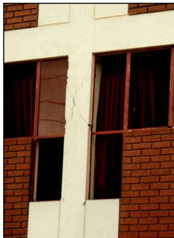
Figura 5. Daño típico de columna corta en edificios de la Universidad Nacional San Agustín de Arequipa.
