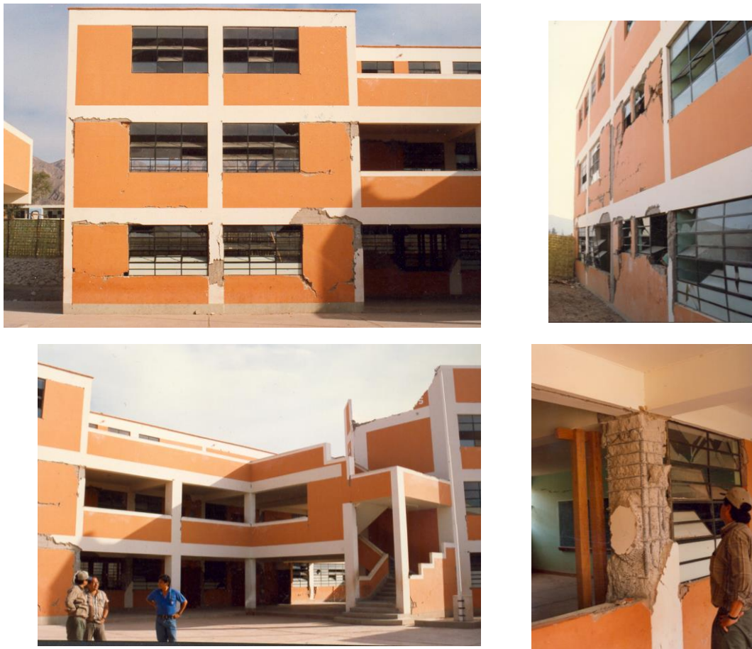
Fig. 3. CE Fermín del Castillo. Daños en los muros de tabiquería en la dirección longitudinal y otros daños de la edificación tras el sismo de Nazca de 1996.
