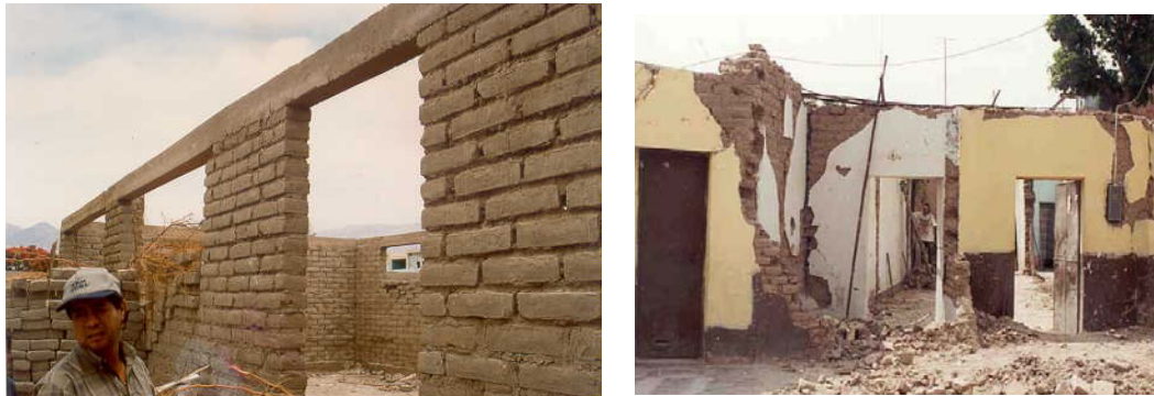
Fig.2. Nazca, Perú, 1996. Adobe confinado sin daños (izq.) y tradicional sin confinar con abundantes daños (der.)
