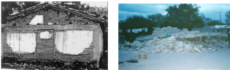
Fig.3. Ometepec, México, 1995. Adobe confinado (izq.) y sin confinar (der.)
