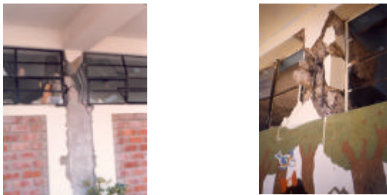
Fig. 4. Fallas de columnas cortas de concreto armado causadas por tabiques de albañilería, sismos de Nasca 1996 (izq.) y Moquegua 2001 (der.)
