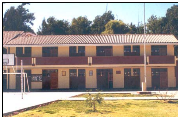
Figura 4. Edificio de centro educativo moderno en Arequipa, construido con criterios de la Norma Sismorresistente de 1997, sin daños tras el terremoto del 2001.
