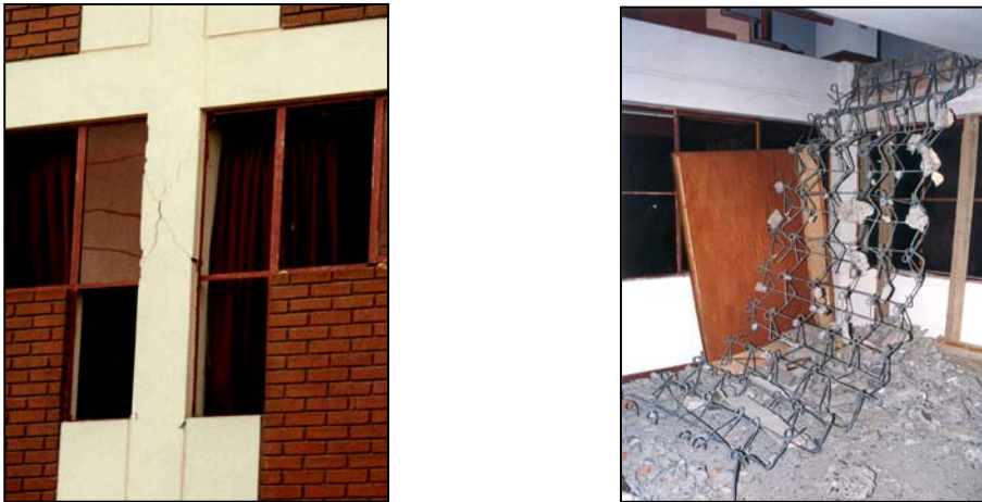
Figura 3. Daños en Universidad Nacional San Agustín de Arequipa: col. Corta (izq.) y escalera (der.) causados por excesivos desplazamientos laterales.
